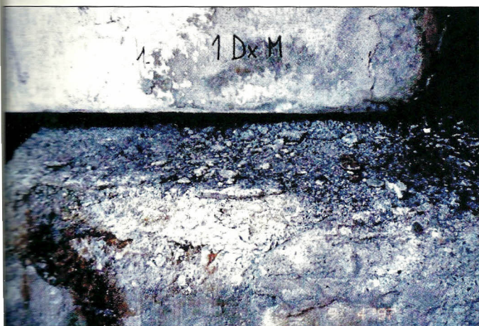
Figura 3 - Degrado del pulvino dovuto a fenomeni di gelo-disgelo ed azione dei cloruri
