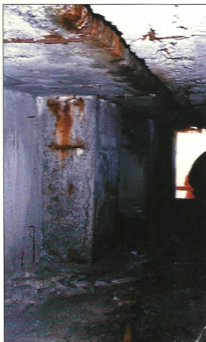
Figura 1 - Corrosione sulla testata di una trave interna e sulla testata delle solette
